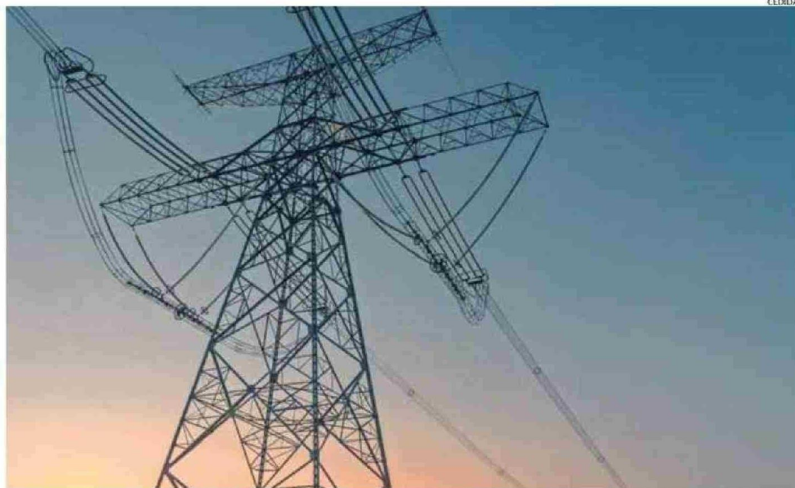
EL CONSUMO ELÉCTRICO ESTÁ EN AUMENTO POR LOS PROCESOS DE CONCENTRACIÓN DE COBRE, LA DESALINIZACIÓN Y EL BOMBEO DEL AGUA DE MAR.
