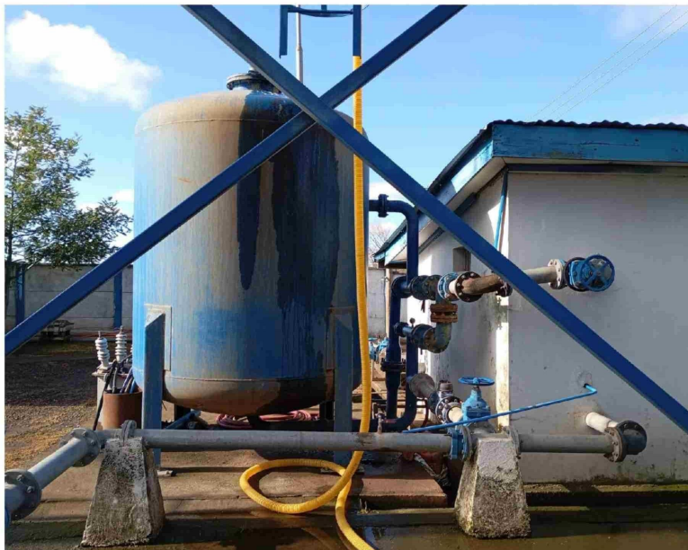
LOS ESTANQUES DEL SISTEMA APR se vaciaron completamente tras la rotura de cañerías provocada por las intensas lluvias de mediados de junio.
