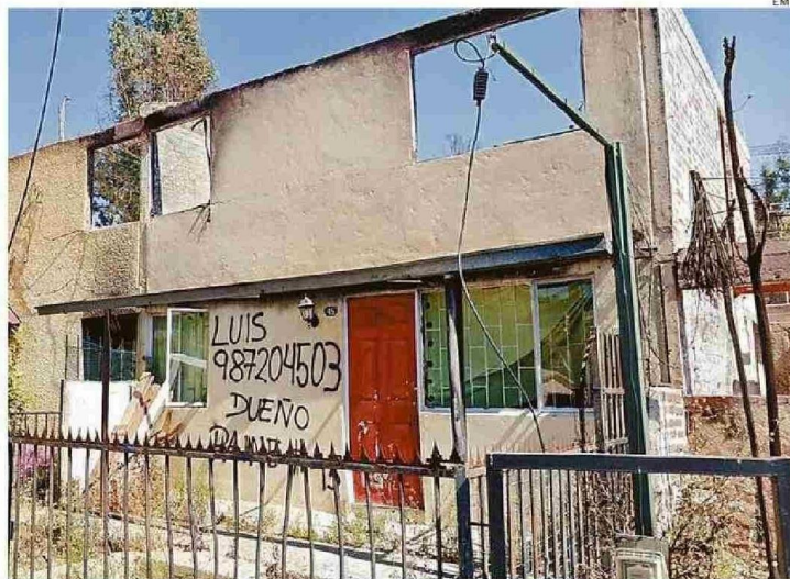
EL MEGAINCENDIO CONSUMIÓ LA CASA DE LUIS SAN JUAN. EL MINVU LE INFORMÓ QUE NO SERÁ RECONSTRUIDO.
