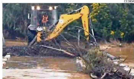
MOP SE ENCUENTRA TRABAJANDO PARA RECUPERAR CONECTIVIDAD.
