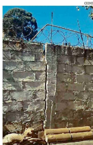
MUROS PERIMETRALES DE VECINOS HAN SIDO AFECTADOS.
