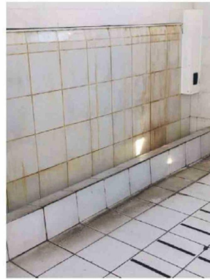
La falta de higiene y la deteriorada infraestructura de los baños es lo que más reclaman los apoderados del Colegio Víctor Domingo Silva de La Serena.
