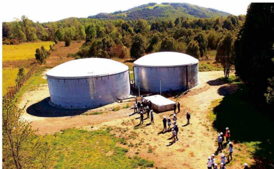
ESTANQUES DE TORMENTA DE PANGUIPULLI QUE SE UBICAN EN LA PLANTA DE TRATAMIENTO DE AGUAS SERVIDAS DE LA CIUDAD.
