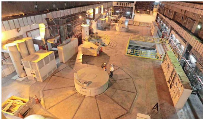
Sala de máquinas de Central Las Lajas.
