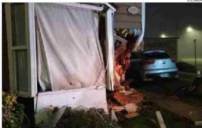
LA CAMIONETA DESTROZÓ PARTE DE LA CASA.
