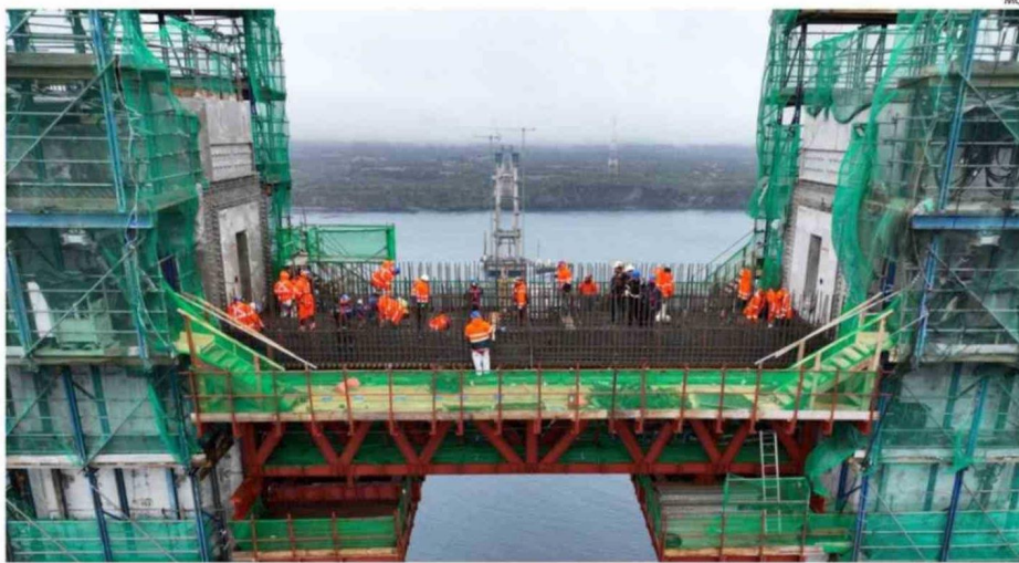
65% ES EL AVANCE QUE PRESENTAN LAS OBRAS DEL MEGAPUENTE, PRINCIPALMENTE EN LAS PILAS QUE SOSTENDRÁN LA ESTRUCTURA
