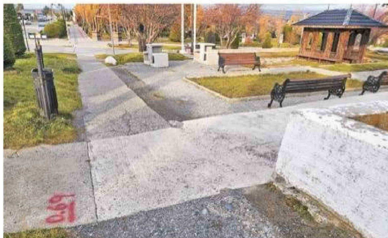
Numerosas son las veredas que registran deterioros desde hace lustros, una de las más dañadas son las de calle Padre Mario Zavattaro, donde se encuentran edificios públicos como la Delegación Presidencial de Tierra del Fuego, cuyo acceso roto muestra la foto.
