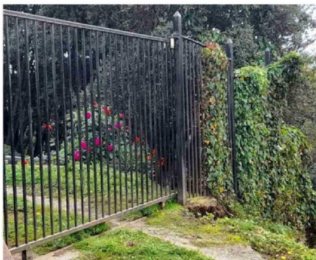
PARTES DEL CERCO DE UNA VIVIENDA QUEDÓ EN EL AIRE.
