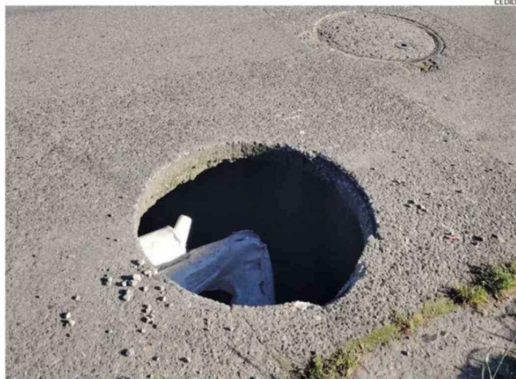
EL HOYO ES DE IMPORTANTES DIMENSIONES Y SE ENCUENTRA EN LA CALZADA QUE VA DE SUR A NORTE.
