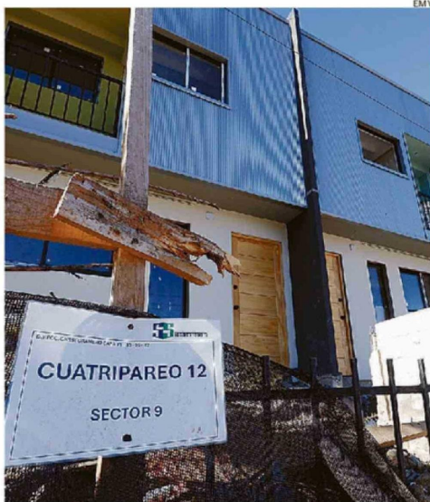
MINVU ARGUMENTA QUE VIVIENDAS NO SERÍAN RESISTENTES AL FUEGO.
