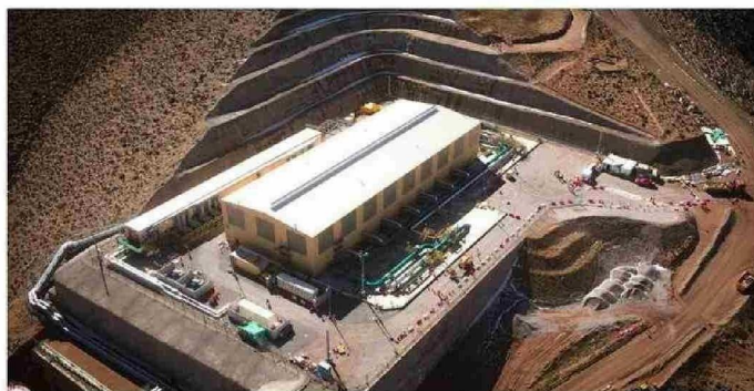
La estación de bombeo 5 es la última y está a más de 3.750 metros sobre el nivel del mar.
