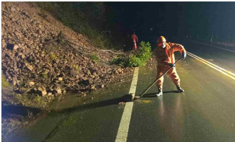
FUNCIONARIOS DE LA DIRECCIÓN DE VIALIDAD trabajaron en la habilitación de la cuesta Mininco, luego de que un deslizamiento interrumpiera la Ruta Q-61-R, que une Santa Bárbara con Alto Biobío.
