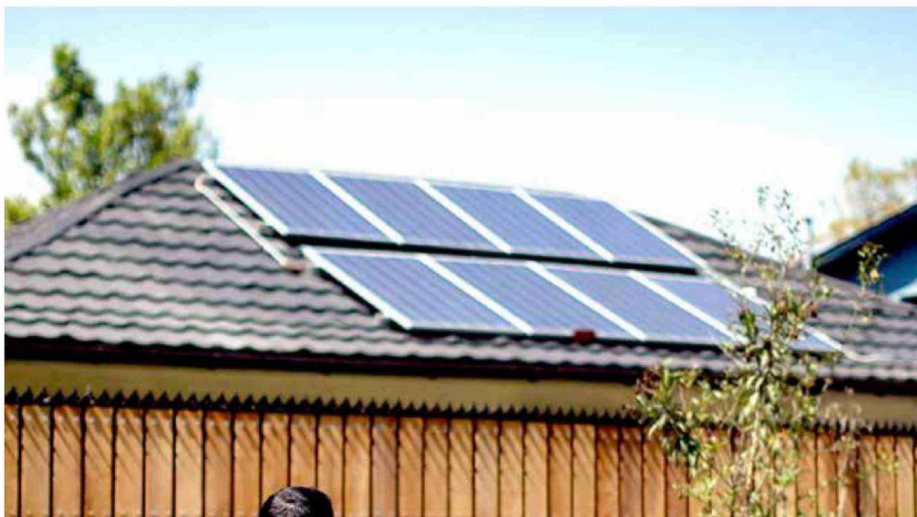
Paneles solares ayudan a ahorrar algunos pesos a quienes los instalan.
