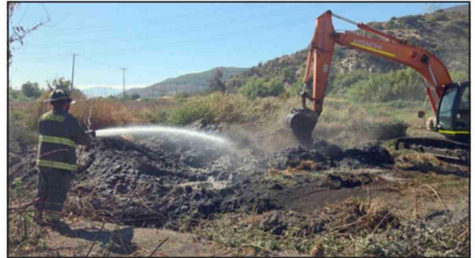
Equipos municipales y Bomberos de Llay Llay extinguieron incendio subterráneo en el sector de la Punta de Diamantes.
