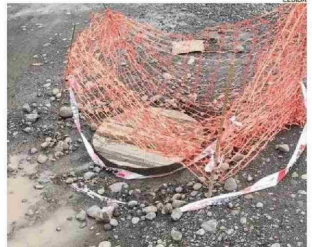
LAS TAPAS DE LAS ALCANTARILLAS ESTÁN MUY DETERIORADAS.
