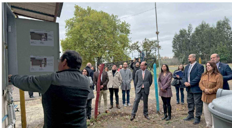
AUTORIDADES REGIONALES y provinciales recorrieron las instalaciones y verificaron en terreno el funcionamiento del sistema implementado en el establecimiento.
