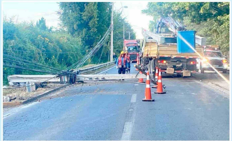
Debido a la caída del poste se produjo un corte de energía eléctrica en el sector
