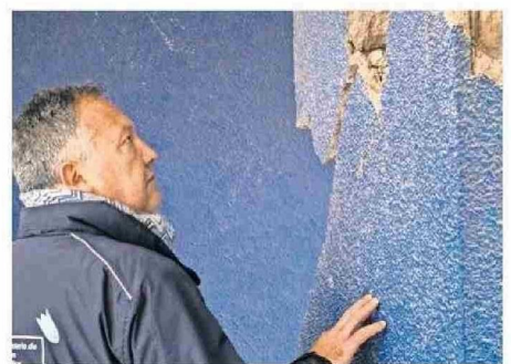
UNA DE LAS GRIETAS QUE ESTÁ CERCA DEL ASCENSOR DEL RECINTO
