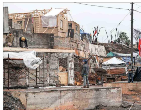
DAÑOS. — Más de cuatro mil familias resultaron afectadas por el megaincendio del 17 de enero pasado, en la provincia de Concepción.
