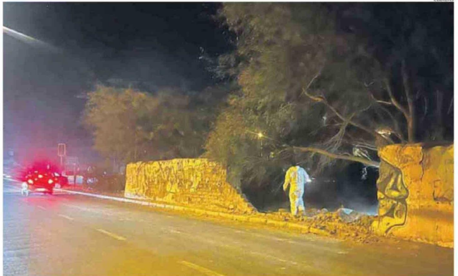
UN MURO SE DESPLOMÓ CERCA DEL PARQUE EL LOA Y FUE UNO DE LOS POCOS DAÑOS EN INFRAESTRUCTURA QUE SE REGISTRÓ TRAS EL SISMO.
