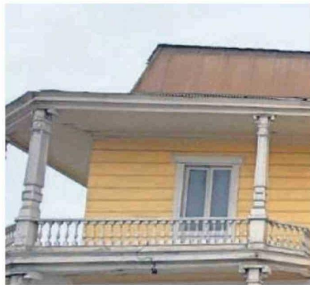
LOS BALCONES Y LA ESTRUCTURA PRESENTAN DETERIORO.
