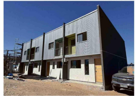
EL MINVU DECIDIÓ DEMOLER MÁS DE 50 VIVIENDAS.
