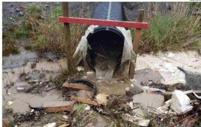
LA FALTA DE UNA INSPECCIÓN OPORTUNA A LAS DESCARGAS EN EL ESTERO LA PALOMA, GENERÓ LAS DENUNCIAS.
