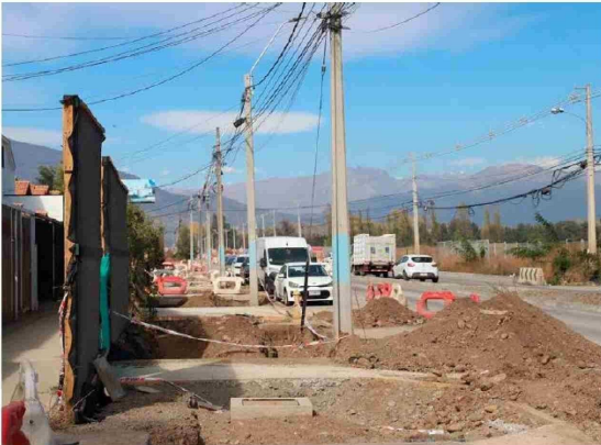
Tras la liquidación del contrato, se aseguró que se está evaluando cómo retomar las obras y finalizarlas prontamente.
