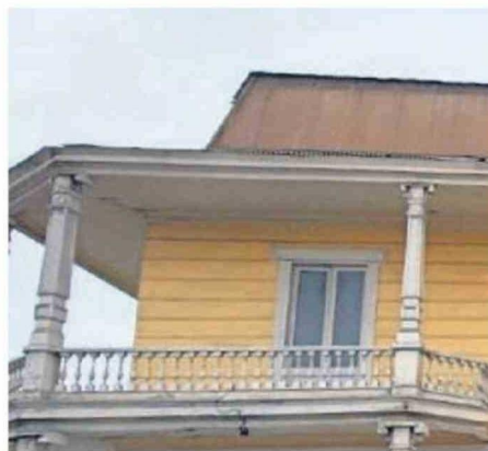
LOS BALCONES Y LA ESTRUCTURA PRESENTAN DETERIORO.
