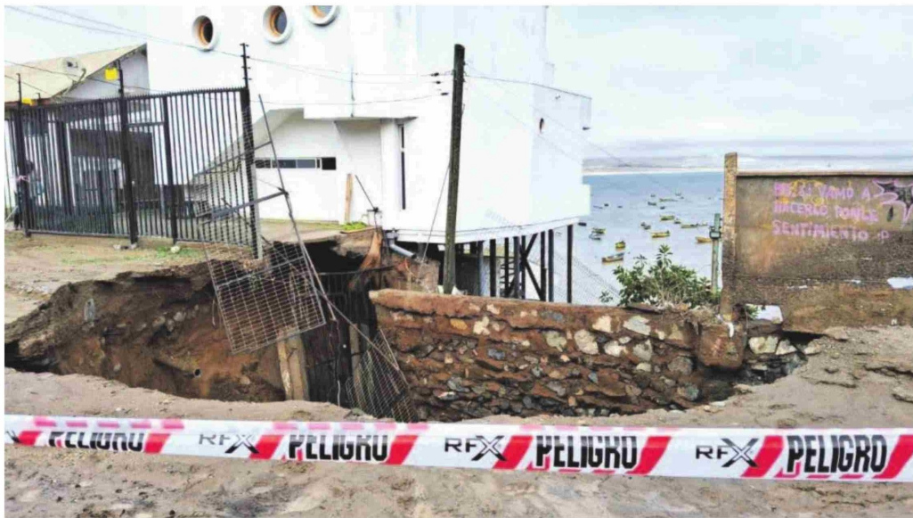
Las últimas lluvias dejaron una gran socavón frente a una vivienda de veraneo en Tongoy.
