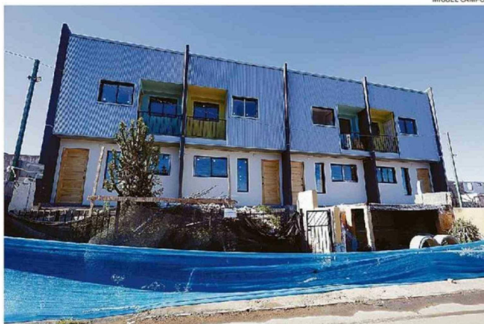
EL INFORME DETECTÓ FALLAS EN MATERIALES, ERRORES DE DISEÑO E INCUMPLIMIENTOS NORMATIVOS.
