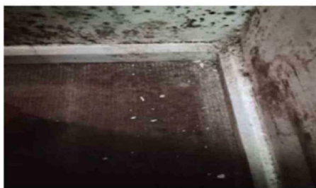
REGISTRO DEL PERITAJE TÉCNICO DE LOS ESTRAGOS DE LA HUMEDAD.
