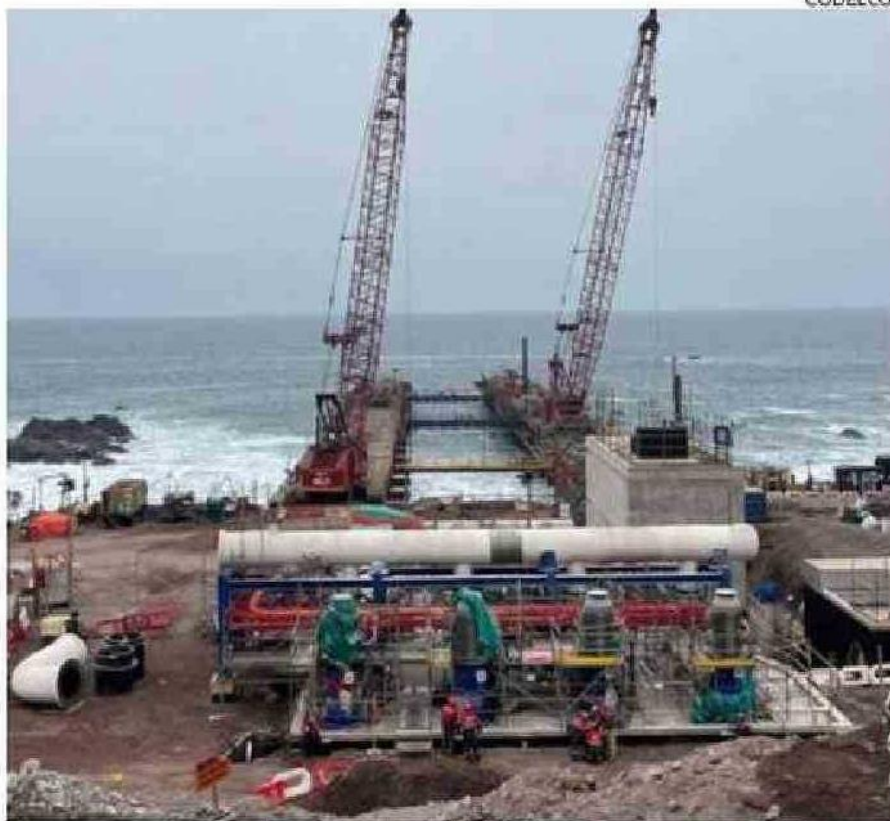
Busca garantizar el suministro hídrico con uso de agua de mar.
