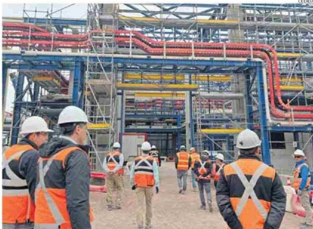
LA DESALINIZADORA DE CODELCO OPERARÁ CON UNA CAPACIDAD INICIAL DE 840 LITROS POR SEGUNDO.
