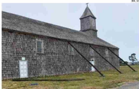
INSPECCIÓN A FINES DE 2024 CONSTATÓ PROBLEMAS.
