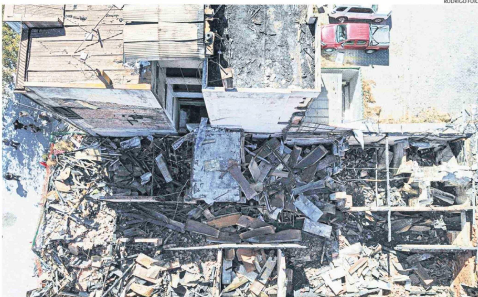
LOCATARIOS ADVIRTIERON QUE PERSONAS HAN INGRESADO ENTRE LOS ESCOMBROS DE LA CASONA DESTRUIDA EN CALLE SAN MARTÍN. RODRIGO FUICA
