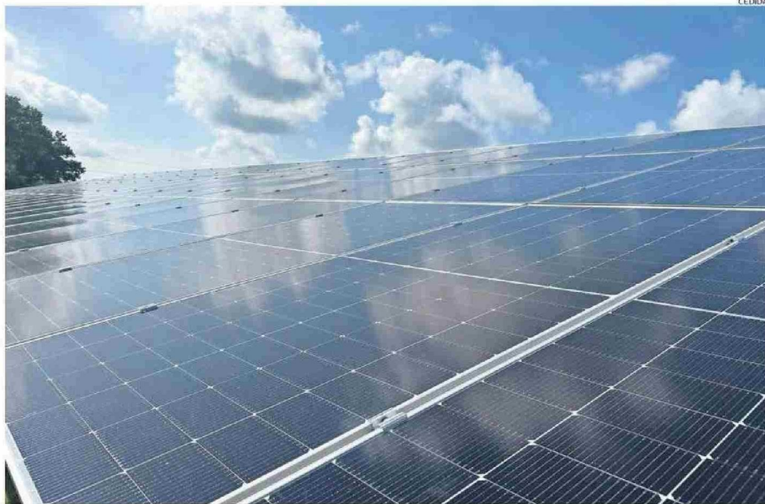
LOS DURMIENTES SE TRATA DEL PRIMER PROYECTO DE RWE APROBADO AMBIENTALMENTE EN CHILE.
