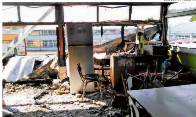
UN INCENDIO DESTRUYÓ LAS DEPENDENCIAS DE LA ESCUELA. COMUNIDAD QUIERE RECUPERARLAS.
