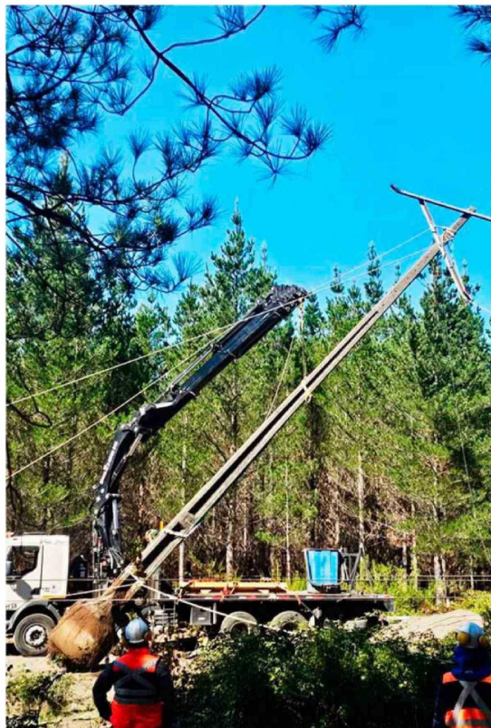
En Charrúa-Chillán, los trabajos se están concentrando en el cambio de estructuras.
