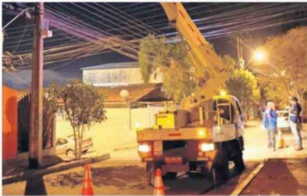
DEBIERON UTILIZAR ESCALAS PARA LLEGAR A LAS LUMINARIAS A INTERVENIR.
