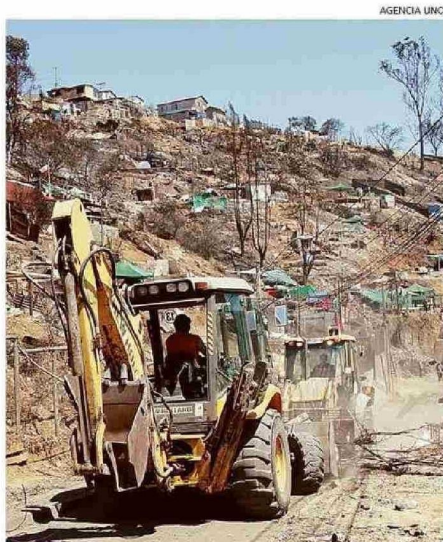
LA DEVASTACIÓN DIO CUENTA DE GRAVES FALENCIAS ESTRUCTURALES.
