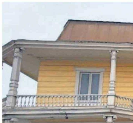
LOS BALCONES Y LA ESTRUCTURA PRESENTAN DETERIORO.
