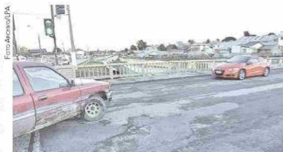
El deteriorado puente de calle Zenteno comenzará a ser repuesto en 2028.
