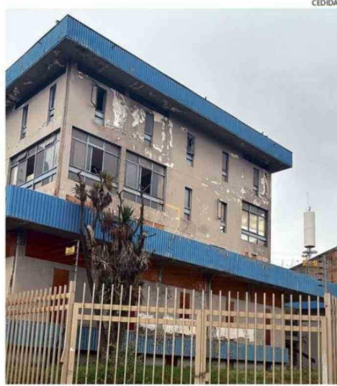
VECINOS ASEGURAN QUE EL ABANDONO DEL EDIFICIO HA GENERADO INSEGURIDAD EN EL SECTOR.
