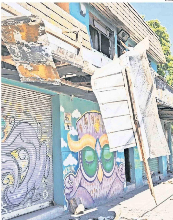
ESTE RECINTO EN ABANDONO EN EL SECTOR ANÍBAL PINTO BAJO TIENE PREOCUPADO A LOS VECINOS.
