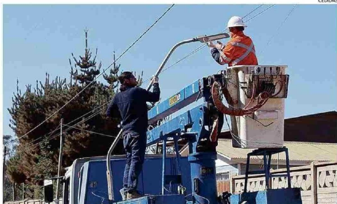
MÁS DE 500 NUEVAS LUMINARIAS SE INSTALARON EN DISTINTOS PUNTOS CON ESTE PROYECTO.
