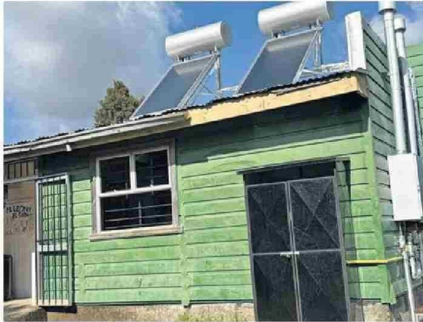
Sistemas solares térmicos fueron parte de las obras.
