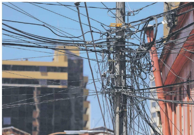
Grave problema. Representan los cables en desuso. / ATON
