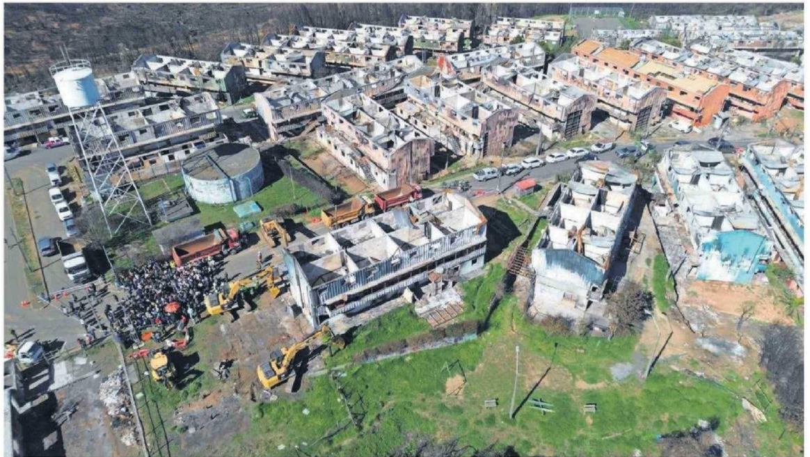
La semana pasada comenzó el proceso de demolición de los block de Ríos de Chile en Lirquén, una de las zonas más siniestradas tras los incendios de enero.
