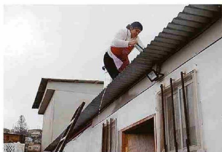
CINCO VIVIENDAS FUERON AFECTADAS POR FILTRACIONES EN LA ZONA DEL 2-F.
